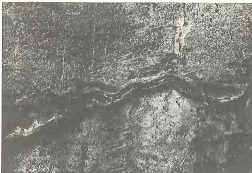
Fig. 3. Skorpelignende, indtørrede, sekundære udfældninger af kalcit (kalciumkarbonat) over revner i lodret betonoverflade. Udfældningernes højde er ca. 3—5 mm. Fra (5611).
