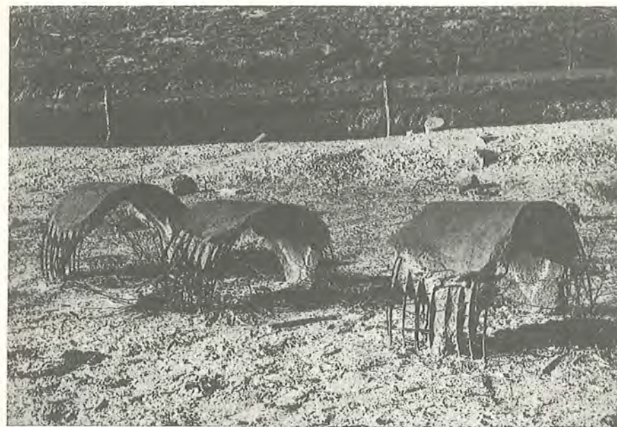
Fig. 8. Rester af betonrør efter få års udlægning i „alkali soils“ i Grand Junction, Colorado, U.S.A. Utvivlsomt har den kapillære opsugning af koncentrerede alkali-sulfatopløsninger fra jordbunden i forbindelse med meget stærk jorddampning i det tørre, varme klima bevirket en ualmindelig hurtig nedbrydning. Foto Ervin Poulsen.
