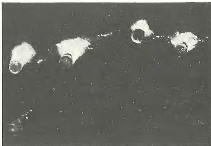
Fig. 4. Stalaktitter af kalcit under udfældning fra overmættet \text{Ca(OH)}_2 -opløsning i revne på undersiden af betonloft i bropille med skadelige alkalireaktioner. Diameter af dråber er ca. 5 mm. Fra (5611).
